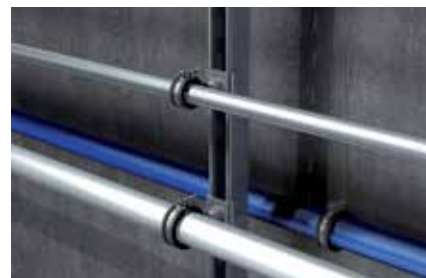
Szerelősínre szerelt csővezeték
