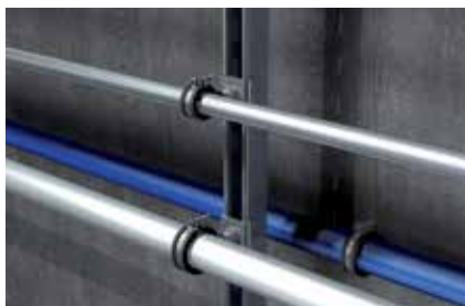
Szerelősínre szerelt csővezeték
